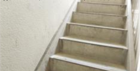
階段に手すりのない市営久保団地
